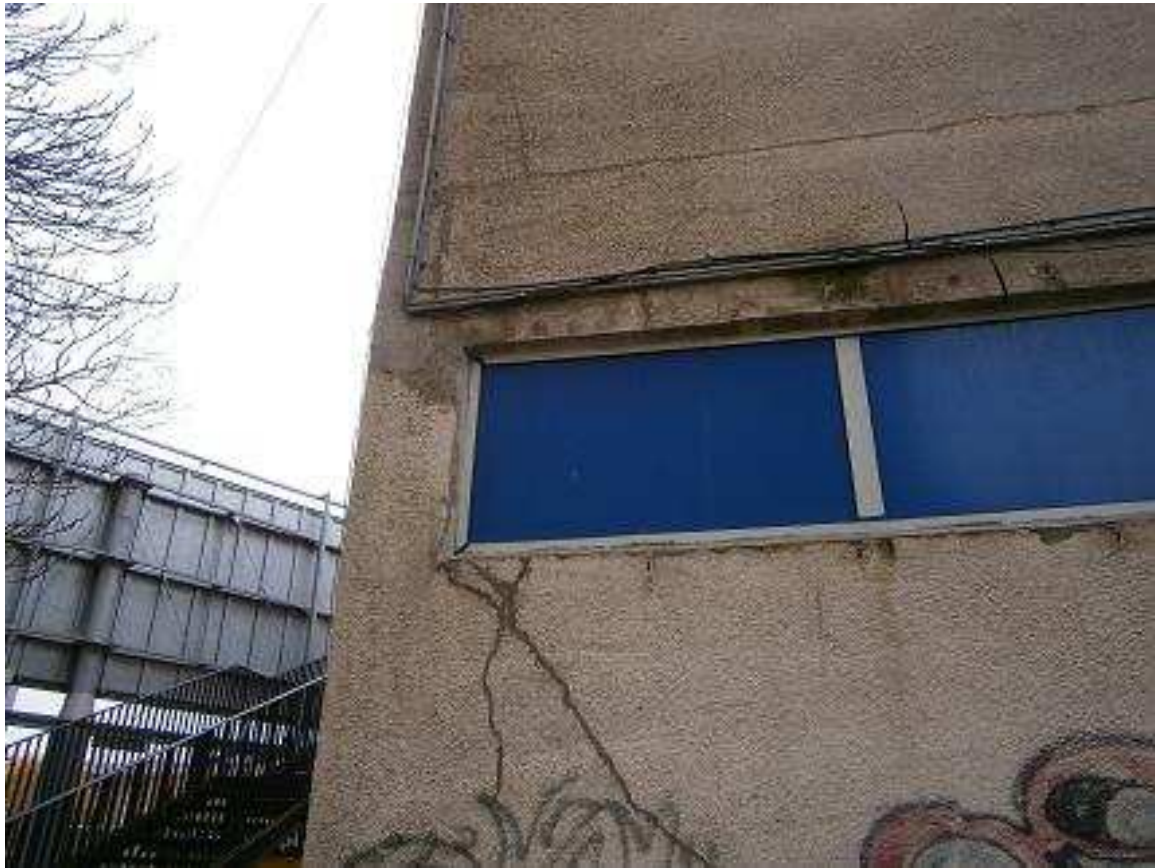
USZKODZENIA ELEWACJI CZĘŚĆ OD ULICY SKIERNIEWICKIEJ
