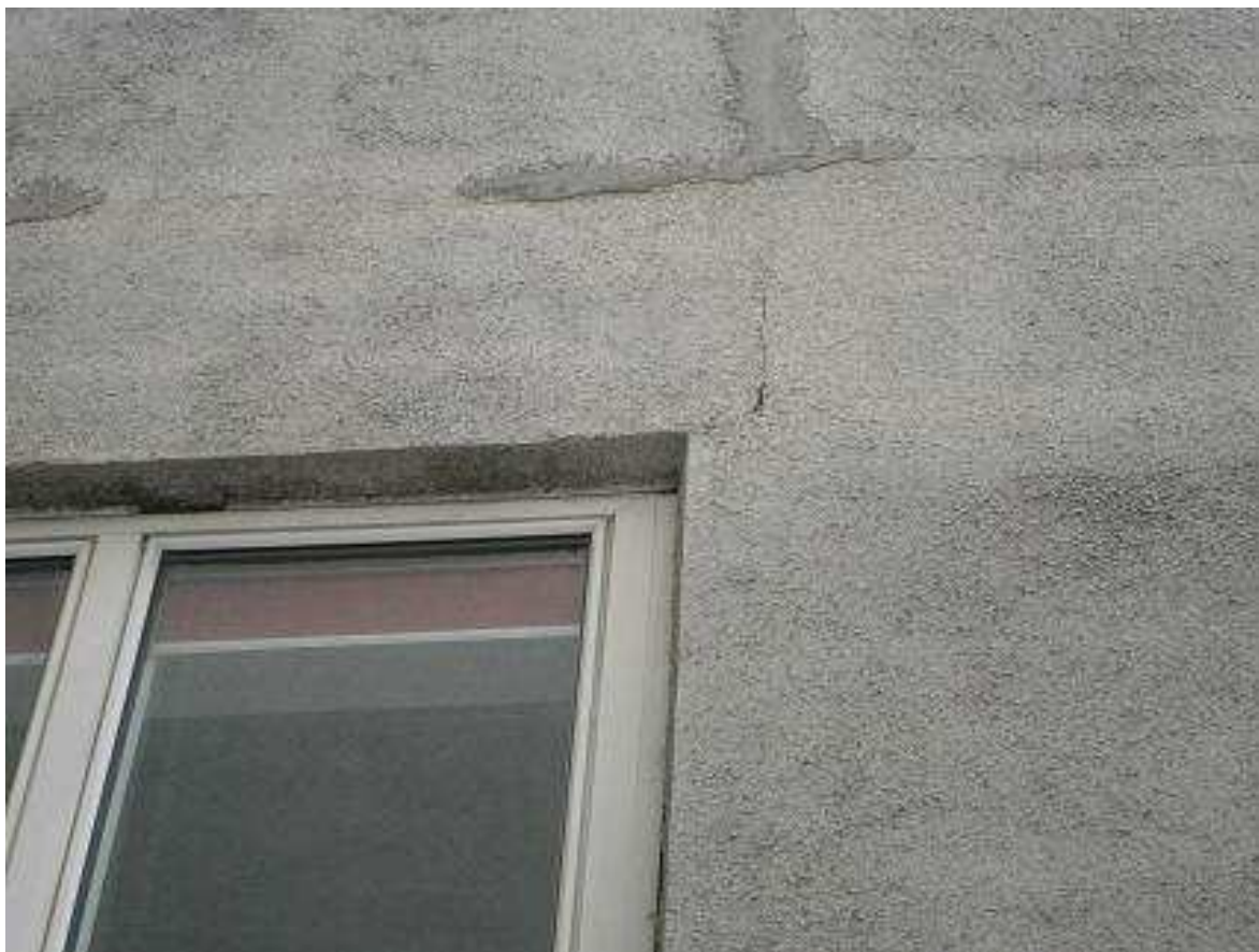
USZKODZENIA BUDYNKU NA ŚCIANIE SZCZYTOWEJ
