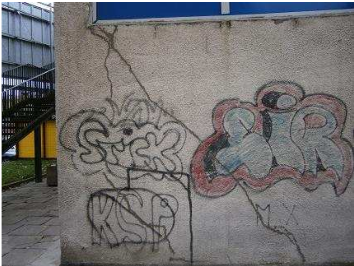
USZKODZENIA ELEWACJI CZĘŚĆ OD ULICY SKIERNIEWICKIEJ
