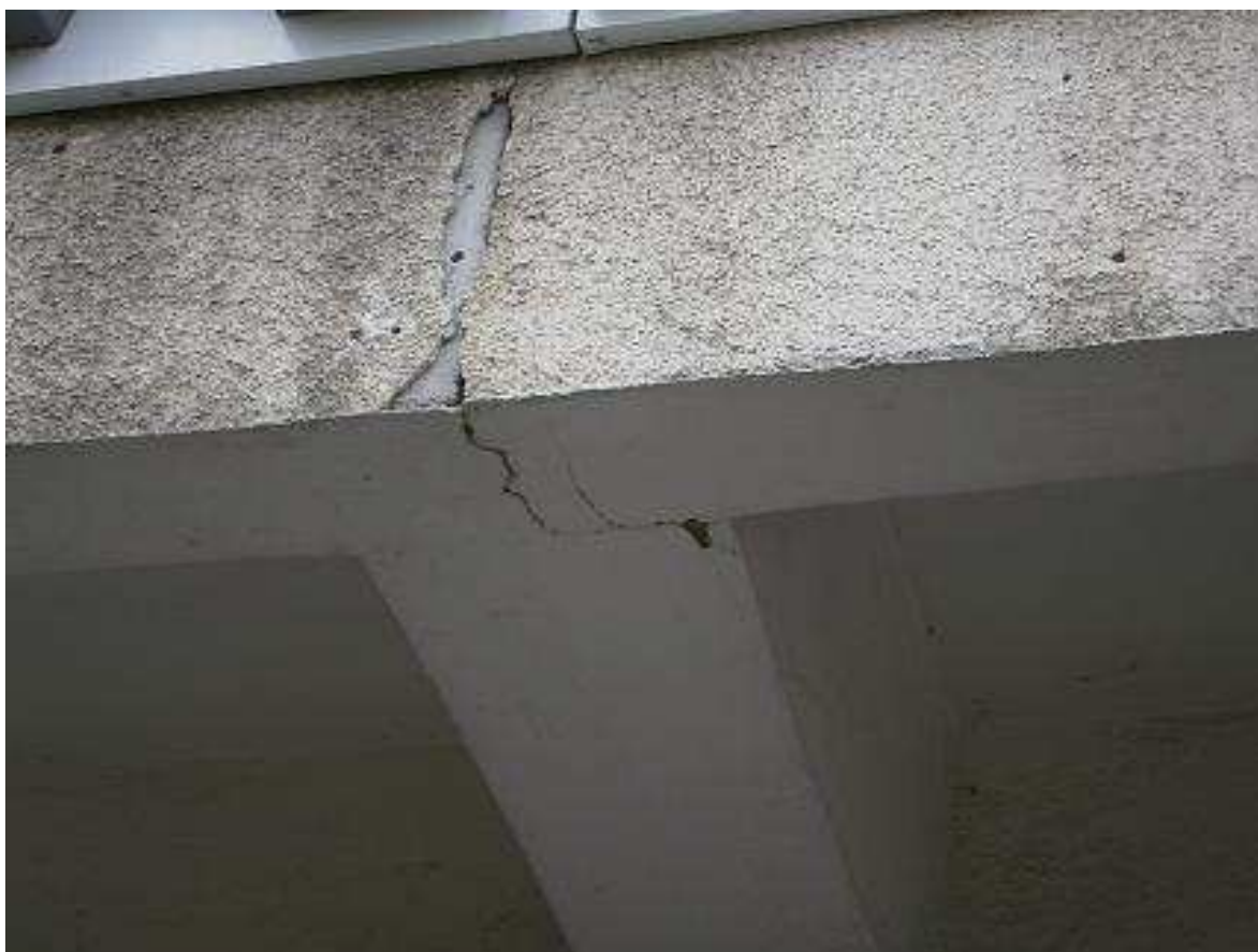
USZKODZENIA BUDYNKU NAD WYKUSZEM
