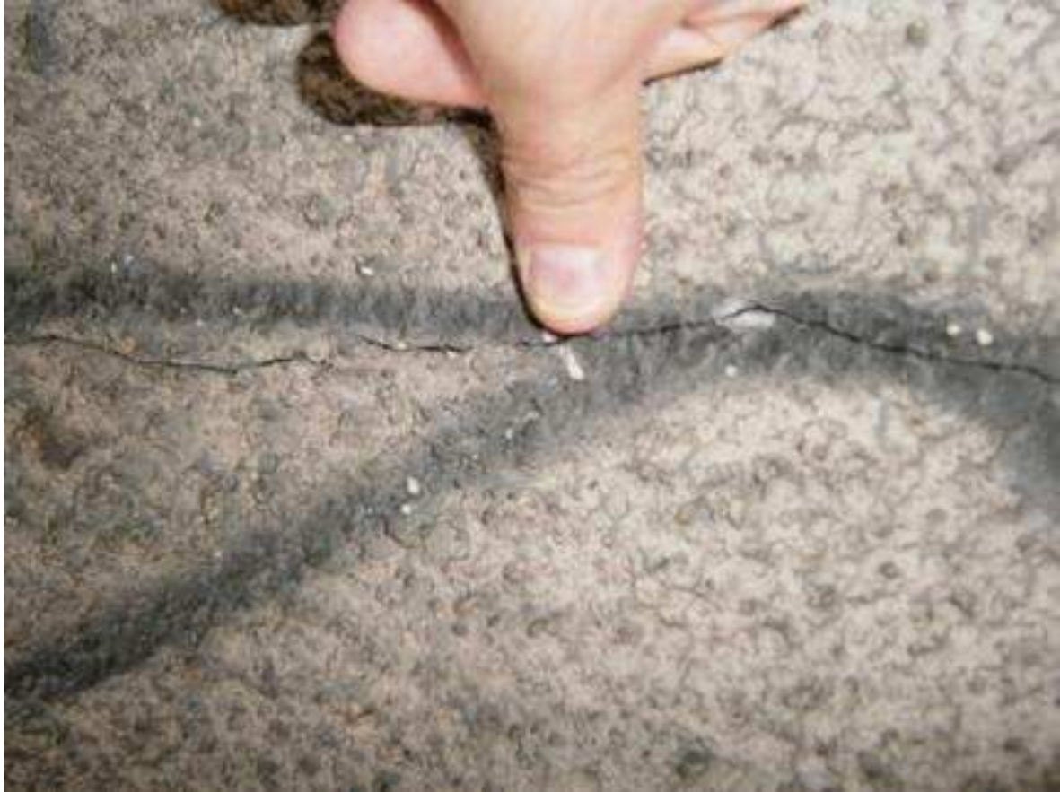
ZARYSOWANIE ŚCIANY W PRZEJŚCIU POŚRODKU BUDYNKU
