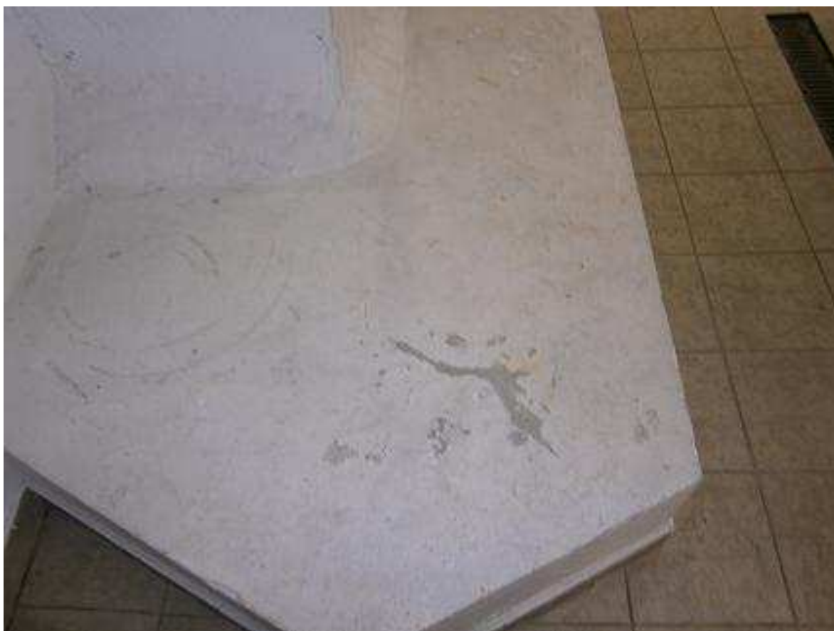
DROBNE RYSU NA STOPIE FUNDAMENTOWEJ
