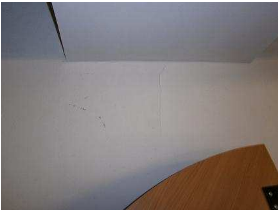
ZARYSOWANIE ŚCIANY W PIWNICY
