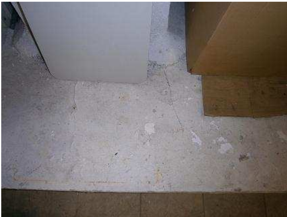
DROBNE RYSU NA STOPIE FUNDAMENTOWEJ
